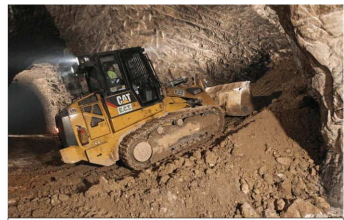
Remblayage total des galeries d'extraction en souterrain (track sur chenilles poussant les remblais de la galerie, carrière de Montmorency)
