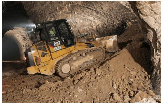
9) Trax sur chenilles poussant les remblais jusqu'au sommet de la galerie (carrière de Montmorency)
